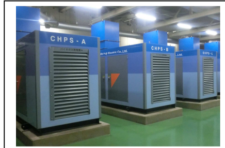
バイオガス発電設備
